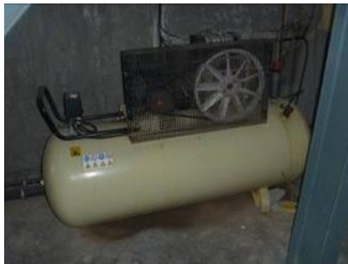
Fotografía 18 Compresor de Aire
