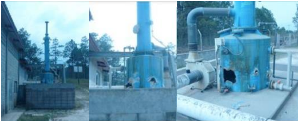
Fotografía 20 Torre de Absorción de Cloro
