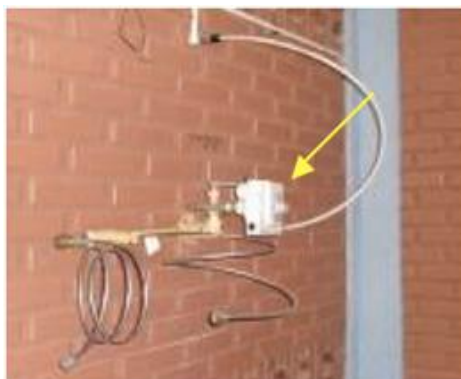
Fotografía 25 Regulador de Vacío Dañado
