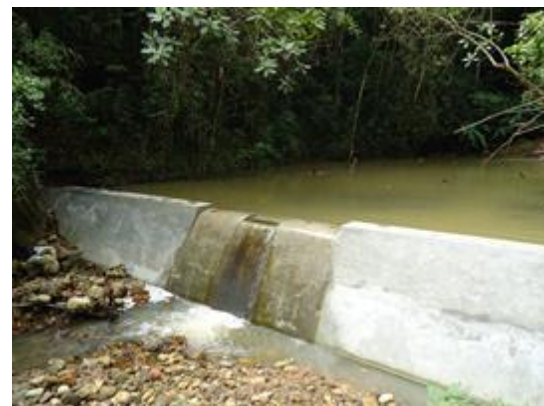
Fotografía 6 Presa de Sedimentación, El Tablón
