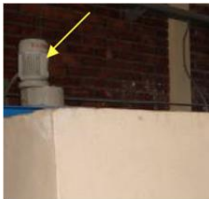
Fotografía 22 Reductor del Agitador de Polímero Dañado
