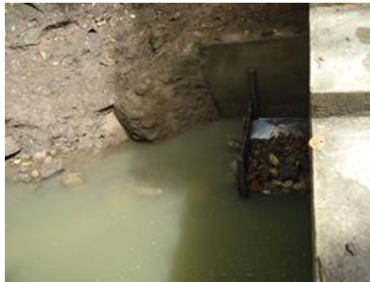
Fotografía 27 Obstrucción en Captación, Presa La Porra
