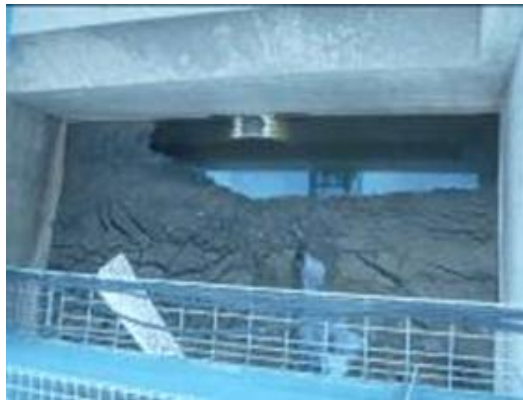
Fotografía 13 Cámaras de Floculación Obstruidas
