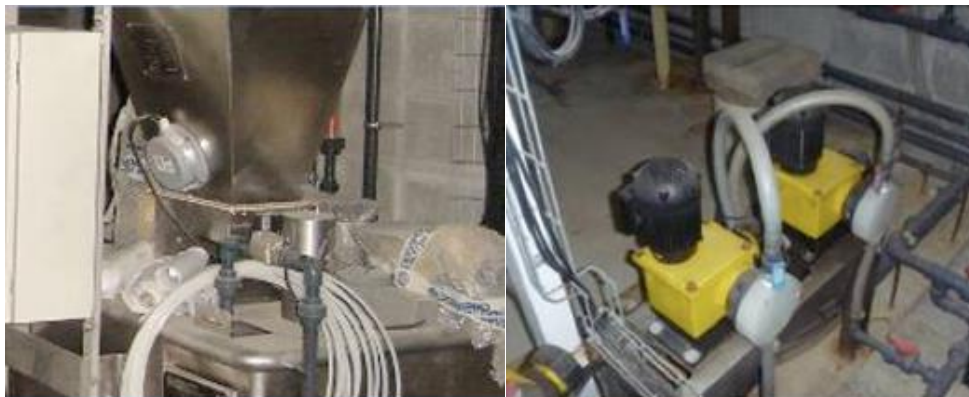
Fotografía 11 Bombas Dosificadoras en Mal Estado
