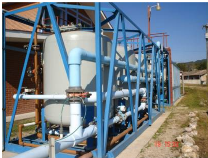
Fotografía 8.7 – Planta de Tratamiento Guaratoro
