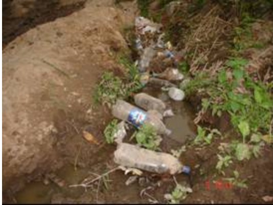
Fotografía 9.4 – Sitio de Descarga colector del Bo. El Parnazo
